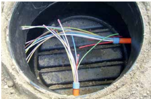
Fot. 9. Studnia KS 80.63/60 w Radomsku, zamontowana w sieci światłowodowej zbudowanej na potrzeby monitoringu miejskiego.
